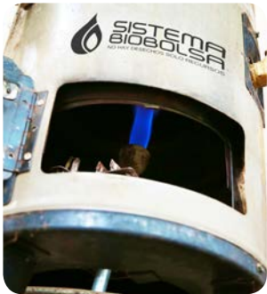
Biogás en calentador de agua
