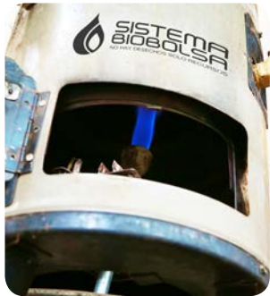
Biogás en calentador de agua
